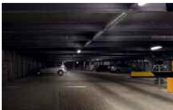
Nočné základné osvetlenie s káblovým spojením trvalého ZAPNUTIA jednotlivých svietidiel
